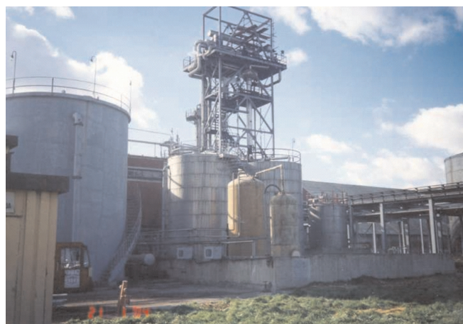
Slika 1 – Dio postrojenja za obradu otpadnih voda ionskom izmjenom
