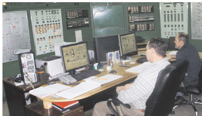
Slika 2 – Kontrolna soba za pripremu i pročišćavanje otpadnih voda
